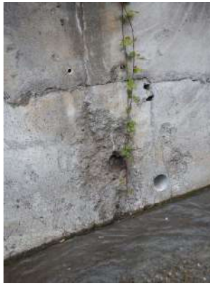
Fissure + altération du béton en pied de mur
