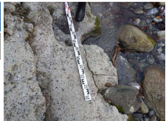
Fissuration + destruction de la semelle en enrochements bétonnés
