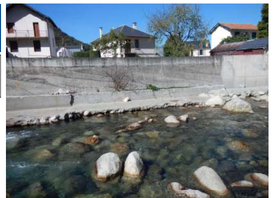
Erosion de la semelle béton
