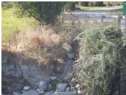
Buse de rejet
