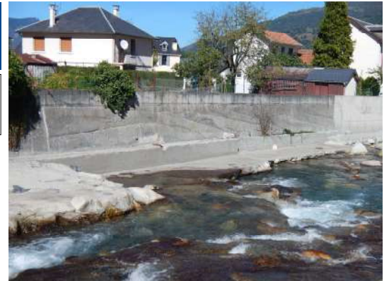
Béton altéré sur le mur de soutènement
