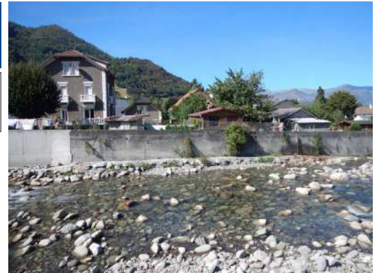
Végétation dans le mur de soutènement + barbacanes + sabot béton
