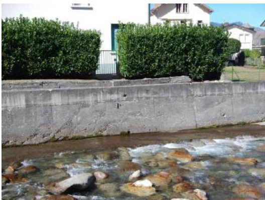
Béton de mur de soutènement dégradé (+ photo DSCN0638.JPG)
