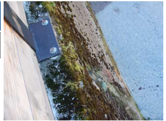
Buse de rejet
