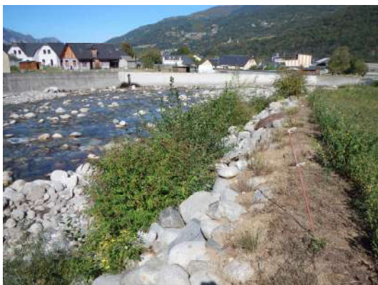
Végétation en pied de talus (Buddleia)
