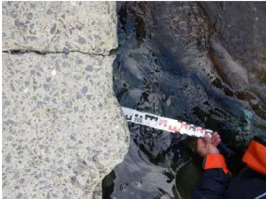
Fissure sur la semelle + affouillement de 0,90m de profondeur sous la reprise en sous-œuvre en enrochements bétonnés
