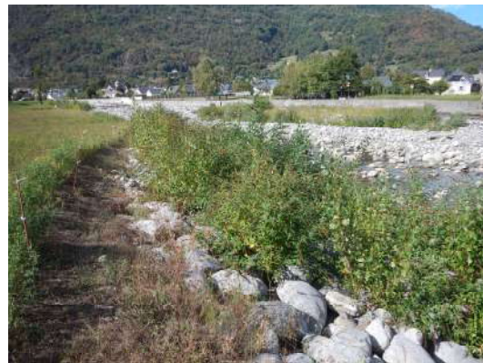
Végétation dense en pied de talus (Buddleia)
