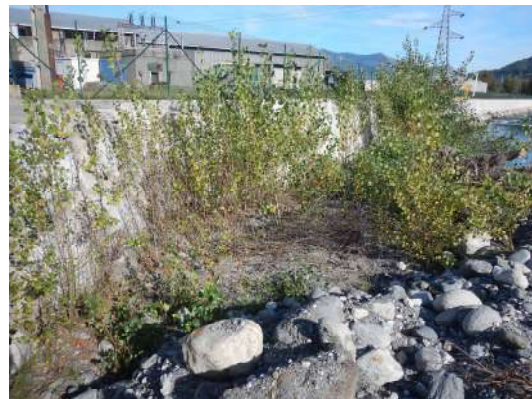
Végétation en pied de mur de soutènement
