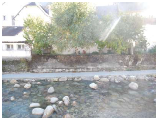
Mousse sur le mur de soutènement + 2 rejets
