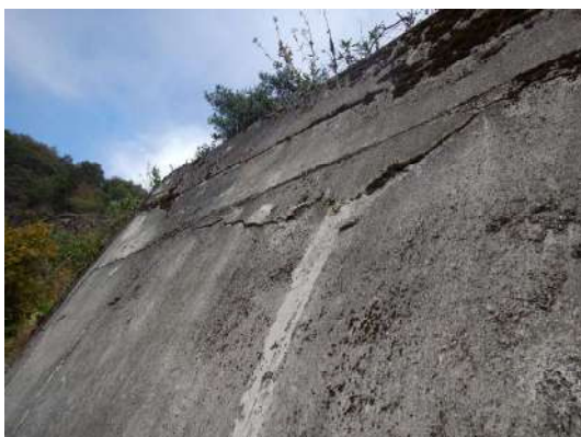
Fissure en tête de mur béton + béton altéré
