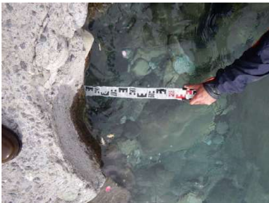
Affouillement de 0,60m de profondeur
