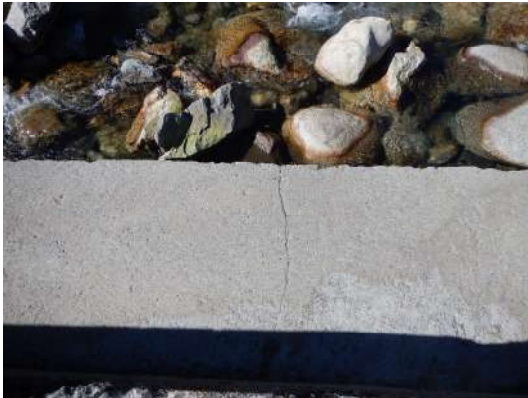
Fissure dans la semelle béton
