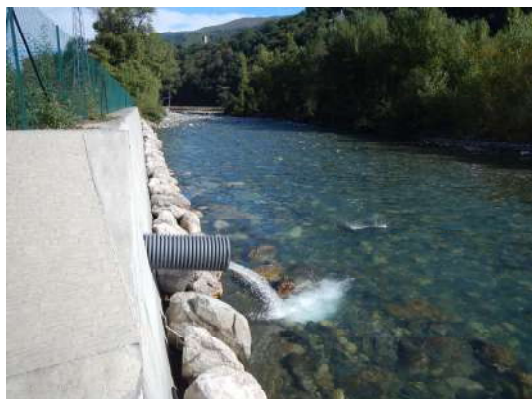
Rejet des eaux de refroidissement
