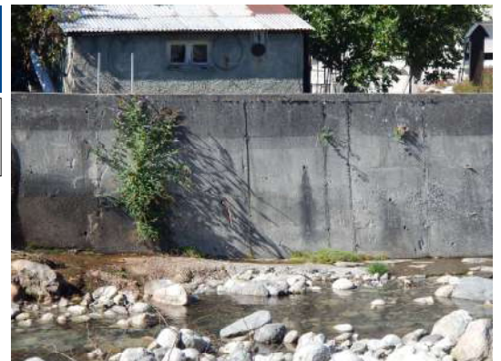
Végétation dans mur de soutènement + fissure verticale
