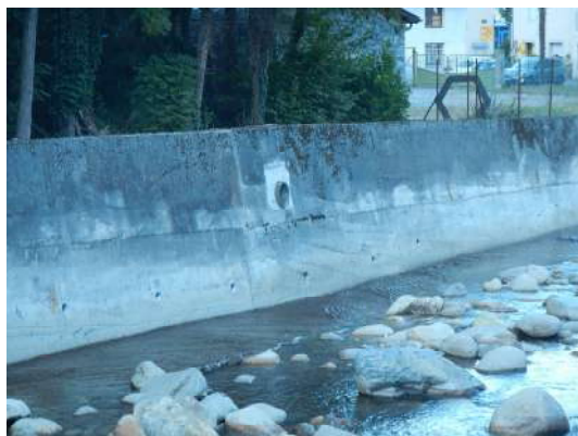
Buse de rejet
