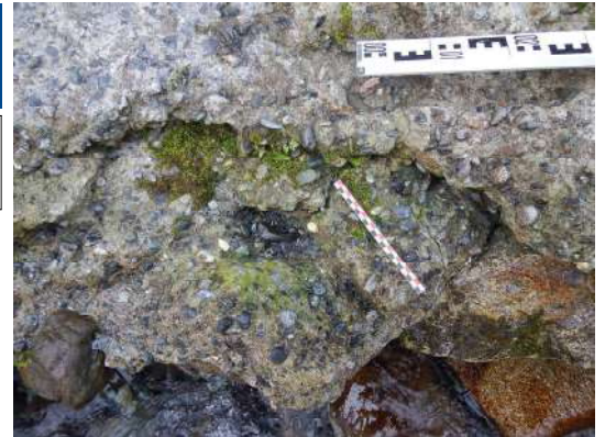
Fissure dans le béton des enrochements bétonnés
