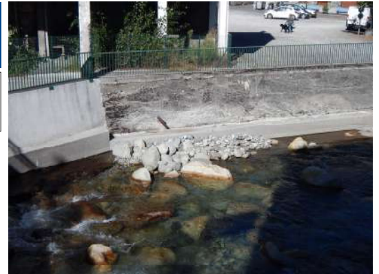
Atterrissement sur la semelle RG + Buse dans mur de soutènement RG
