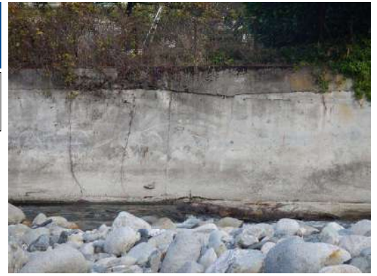
Ferrailage apparent en pied de mur + mur béton altéré + traces d'impacts
