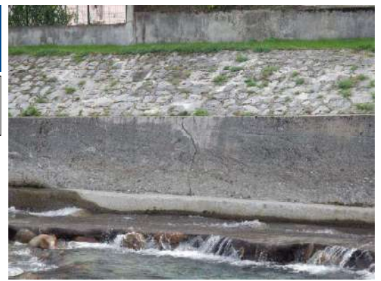
Fissure verticale dans le mur de soutènement béton sous le perré maçonné
