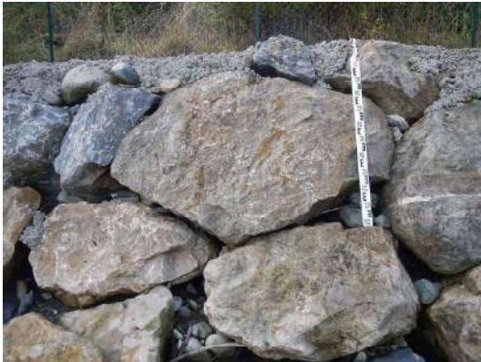
Mauvaise disposition des enrochements (gros bloc en tête de protection)
