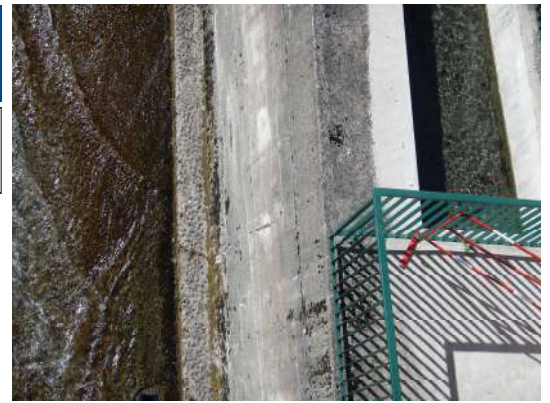
Fissure verticale sur mur de soutènement RG
