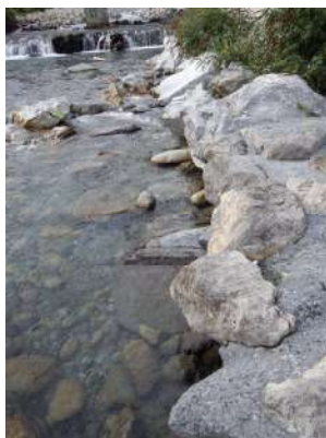
Affouillement de 0,50m sous le sabot en enrochements bétonnés
