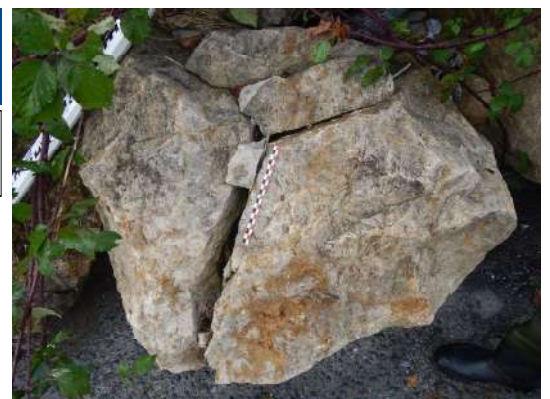
Eclatement d'un bloc d'enrochement
