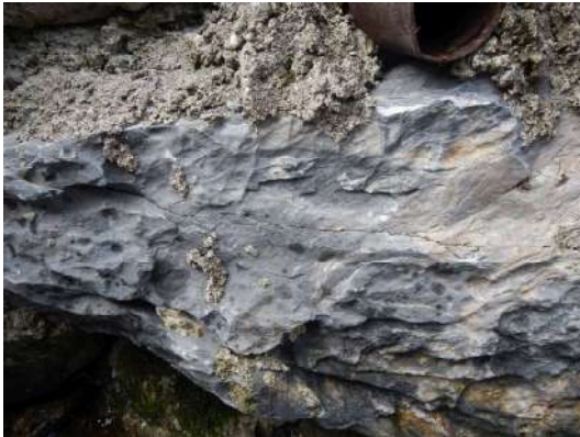
Fissure sur bloc d'enrochement
