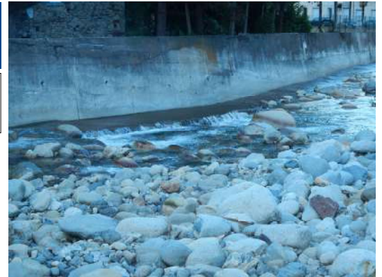
Affouillement sous la semelle béton
