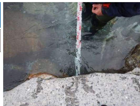
Affouillement de sous la semelle en enrochements bétonnés
