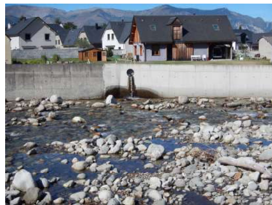
Buse de Rejet (+ photo DSCN0655.JPG)
