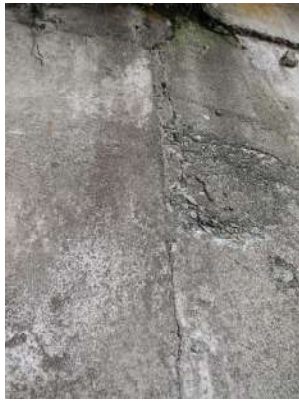
Fissure + gravillons du mur béton apparents
