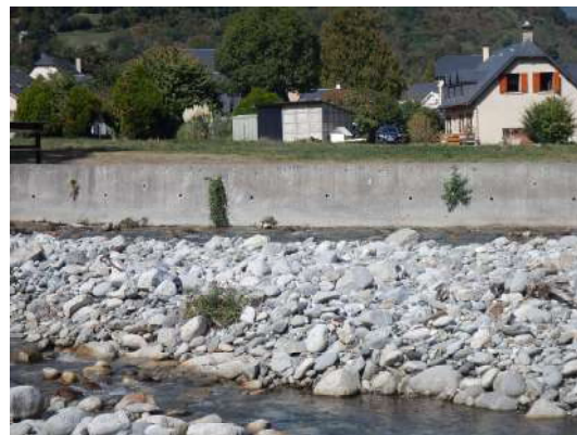
Végétation dans le mur de soutènement béton
