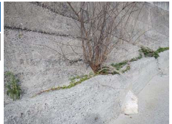
Végétation dans le mur de soutènement béton
