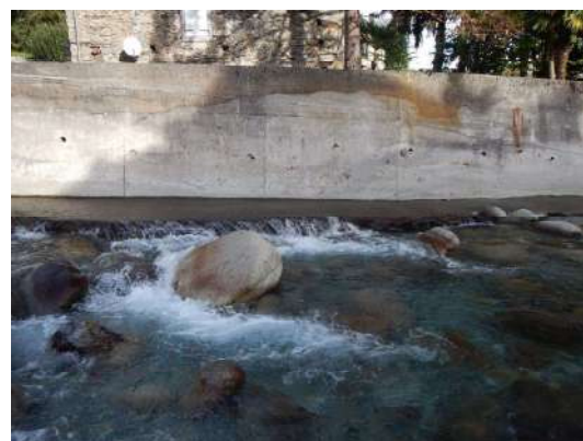
Affouillement sous la semelle béton
