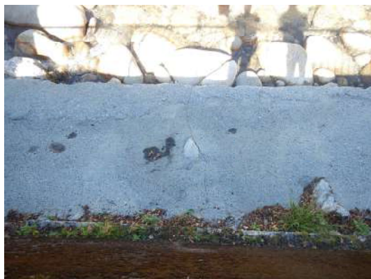
Fissure dans la semelle béton
