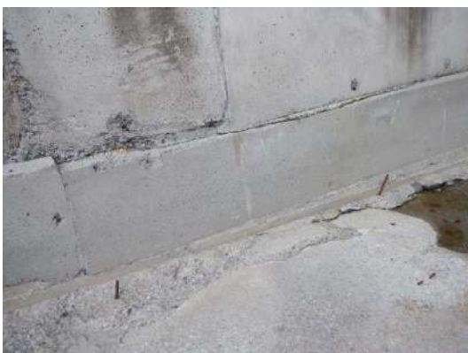
Ferrailage apparent dans le mur béton
