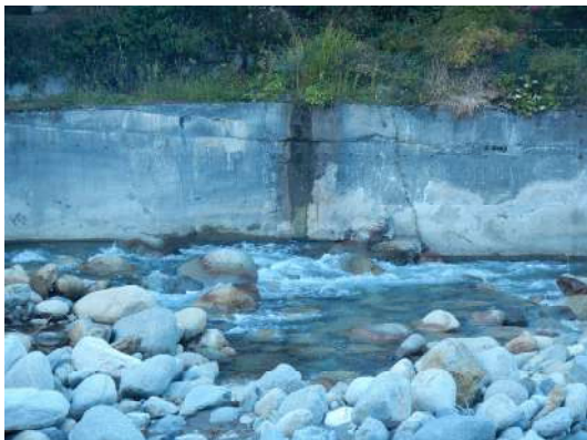
Fissure verticale dans le mur de soutènement + mur de soutènement altéré
