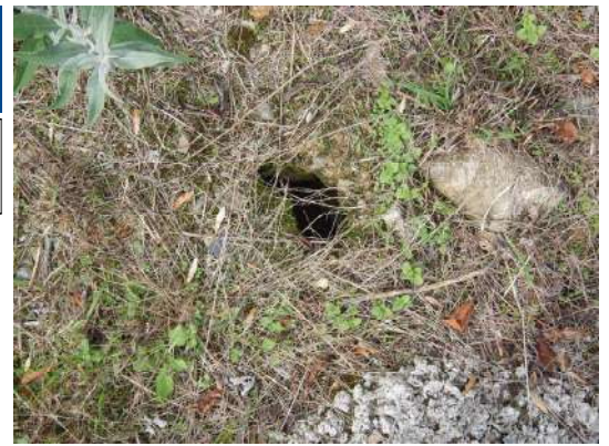
Fontis en crête de mur de soutènement en enrochements bétonnés
