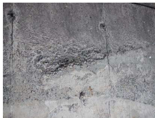
Altération du béton : gravillons apparents (mauvaise mise en oeuvre du béton à la construction)
