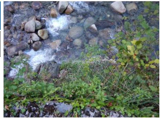
Végétation dans le mur maçonné
