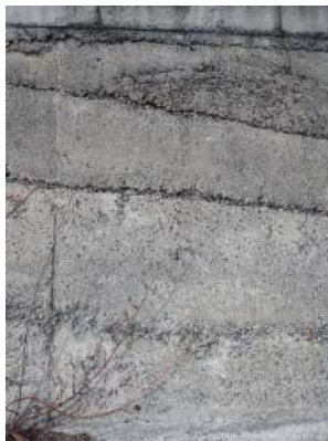
Altération du béton : gravillons apparents (mauvaise mise en oeuvre à la construction / réhaussement)
