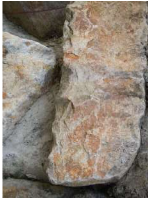
Mauvaise mise en oeuvre des enrochements (bloc posé verticalement)
