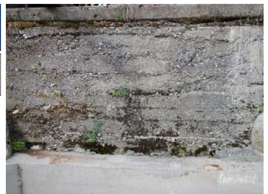
Béton du mur de soutènement altéré
