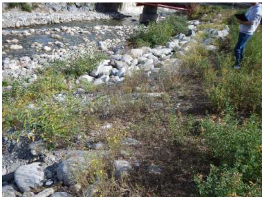
Rampe d'accès sauvage sur le talus
