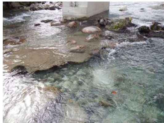
Affouillement sous le béton de la pile de pont centrale
