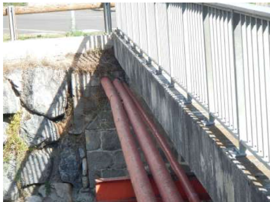
Choc visible sur canalisations à l'amont du pont interzone
