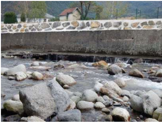
Affouillement sous la semelle + semelle dégradée
