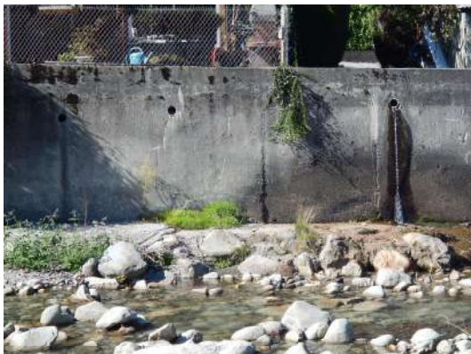
2 Buses rejet EP + Fissure sur le mur de soutènement béton
