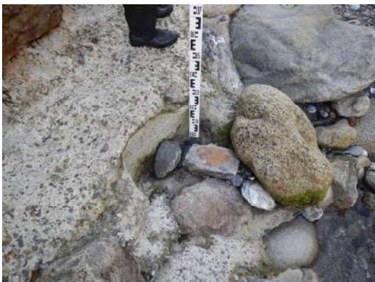
Destruction de la semelle en enrochements bétonnés
