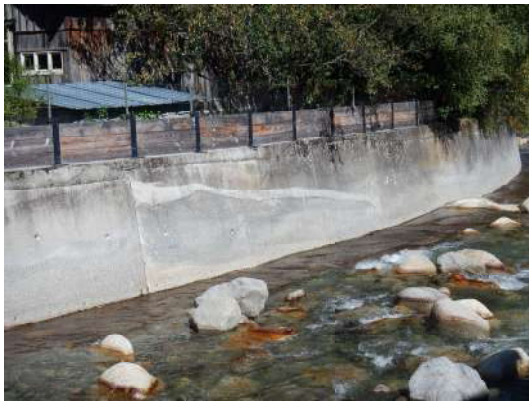
Fissure dans le mur de soutènement béton
