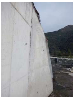
Fissure verticale à la transition GC47.2 / GC 48.1
