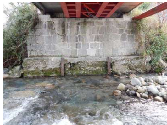
Erosion du béton du pied de la culée du Pont Interzone
