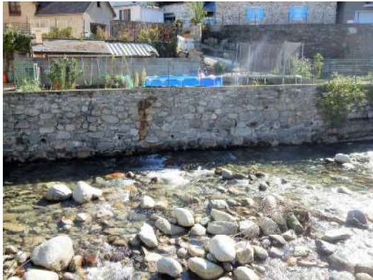
Barbacanes dans mur de soutènement + Suintement ?
