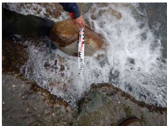
Affouillement de 0,40m de profondeur sous la semelle béton
