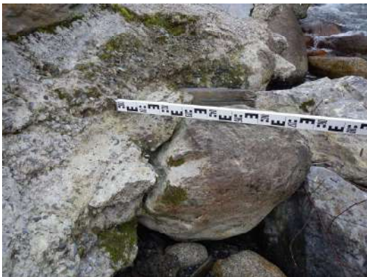
Destruction de la semelle en enrochements bétonnés
