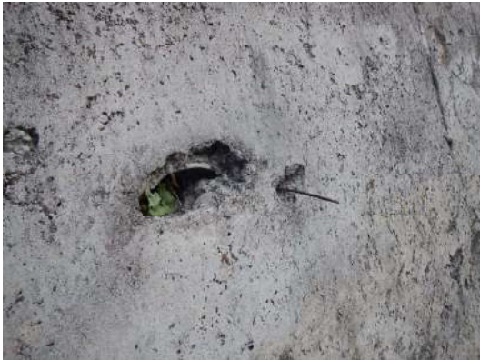
Ferrailage apparent + barbacane obturé (sur tout le tronçon)
