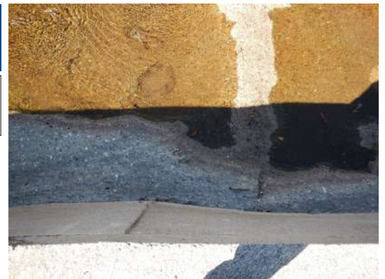
Ferrailage appenrent dans la semelle béton + érosion
