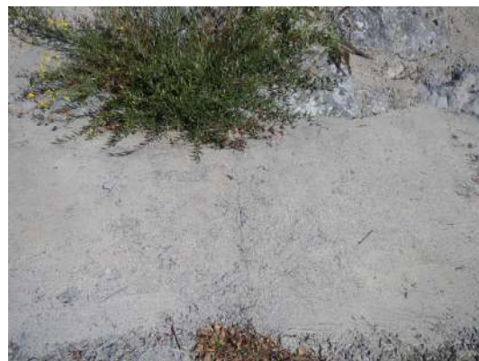
Fissure sur la semelle béton
