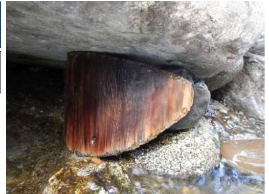
Gros bloc d'enrochement reposant sur bloc de petit diamètre + Affouillement
