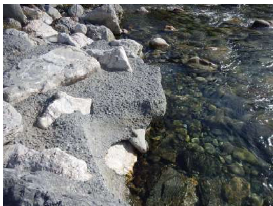
Léger affouillement sous le sabot béton
