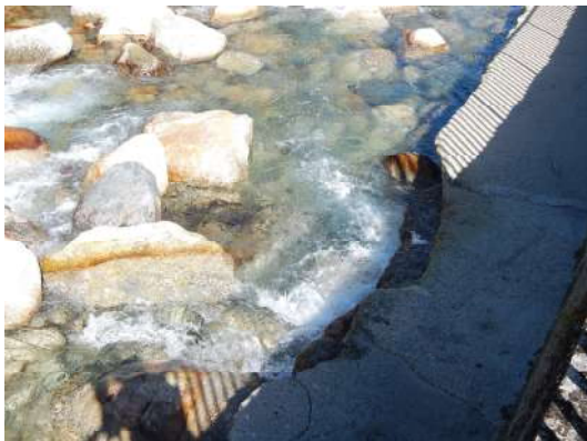
Incision du lit et de la semelle béton sur 20cm et affouillement sous la semelle (au droit de la barrette B5) (+ Photo DSCN0633.JPG)
