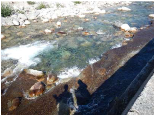
Affouillement sous la semelle béton
