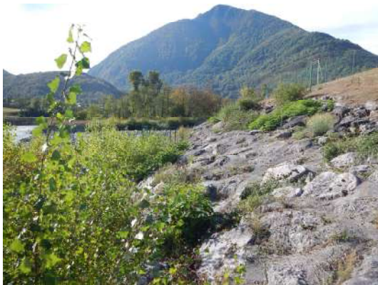
Végétation arbustive dans le talus en enrochements bétonnés
