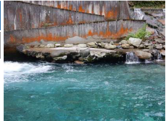
Affouillement sous la semelle à l'aval RG du seuil
