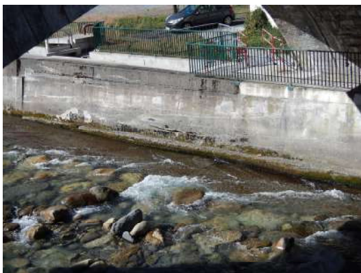
2 Fissures verticales sur le mur de soutènement + Traces d'impacts d'enrochements
