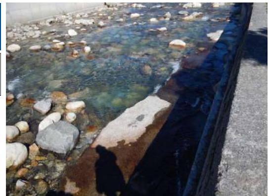
Erosion de la semelle
