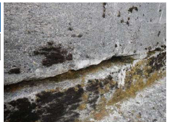
Joint altéré et large entre la plinthe et le mur de soutènement
