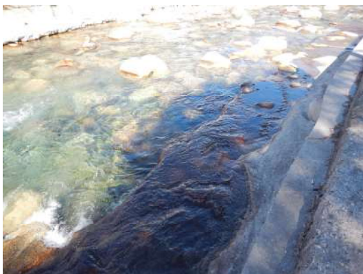
Erosion de la semelle béton
