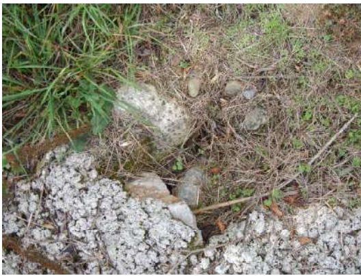
Fontis en crête de mur de soutènement en enrochements bétonnés
