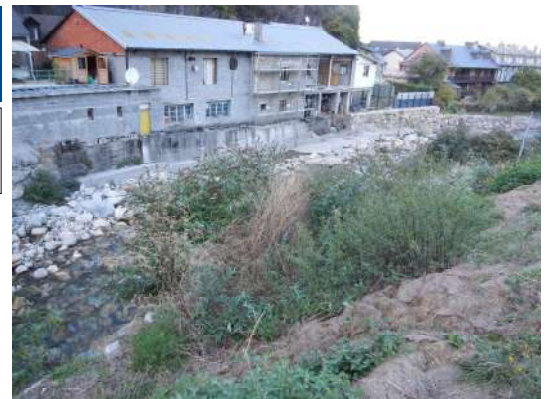
Végétation dense en crête du mur de soutènement en enrochements bétonnés (Buddleia)
