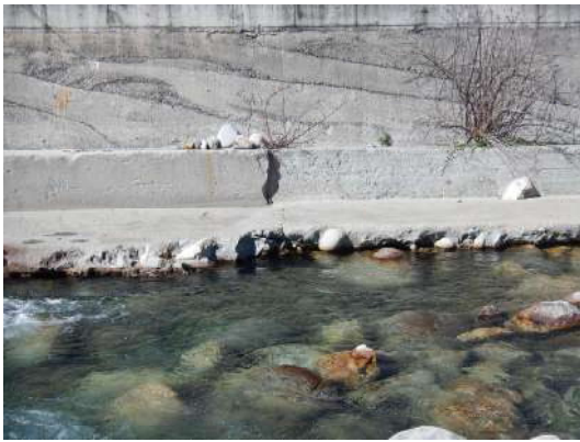
Fissure qui se prolonge sur le mur de soutènement (+ photo DSCN0642.JPG)
