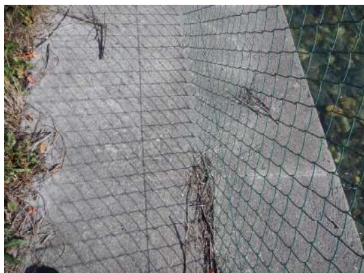
Fissure en crête en milieu de plot
