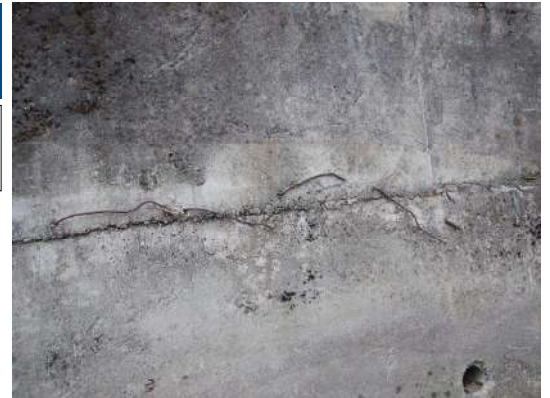
Ferrailage apparent sur le mur béton
