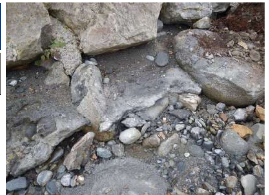
Semelle béton dégradée lors des travaux de pavage (oct 2018)
