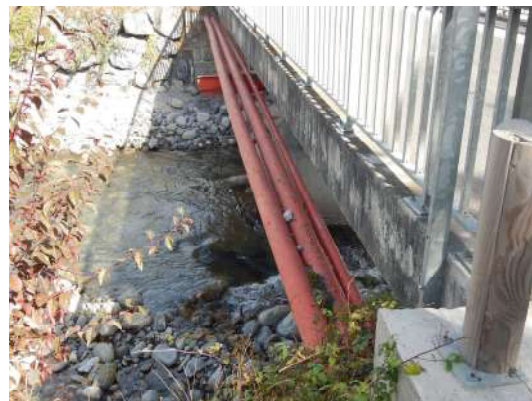
Canalisations à l'amont du pont interzone
