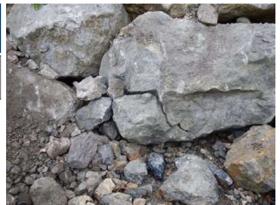
Bloc d'enrochement cassé lors de travaux (oct 2018)
