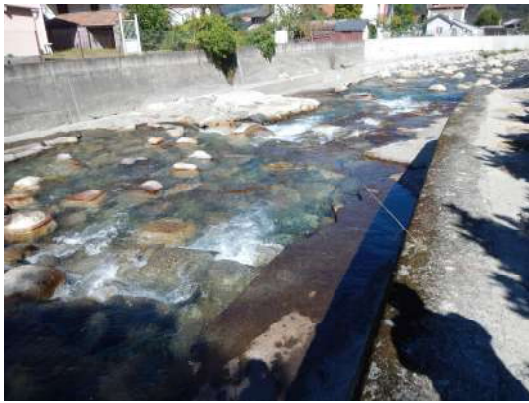
Affouillement en amont du seuil E
