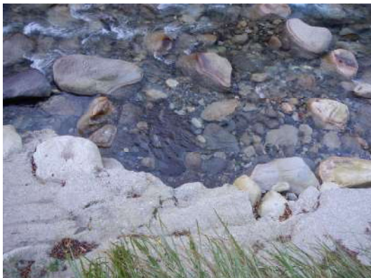
Semelle béton dégradée
