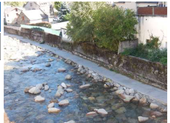
Mousse sur le mur de soutènement (tout le tronçon)
