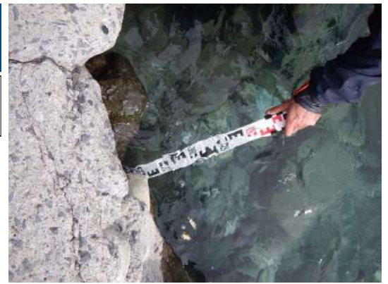
Affouillement de 0,60m de profondeur
